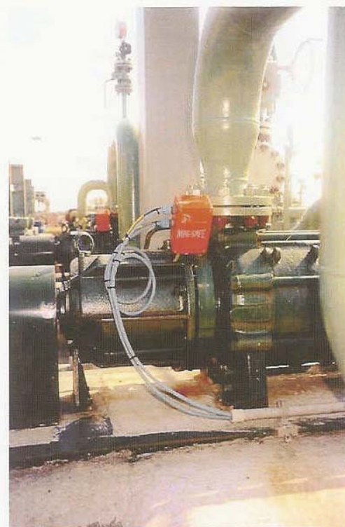
1: Mehrstufige Gliederpumpe mit „MAG-SAFE“ Überwachung zur Auslagerung von Propan/Butan im Raffineriebetrieb
